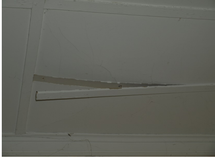
Asbestos trim loose
